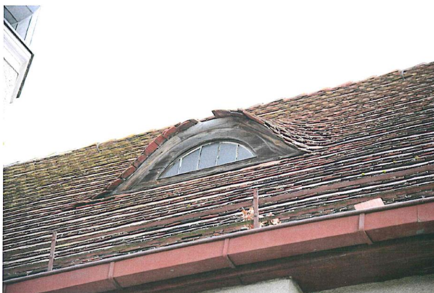
Fot. 7 Wole oko w połaci dachu.
