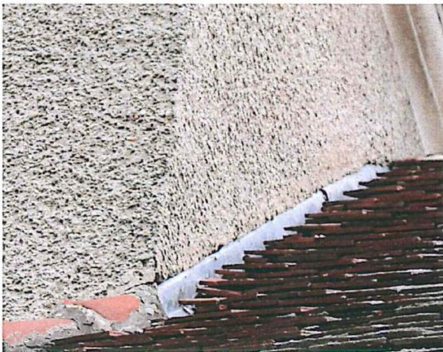
Fot. 2 Obróbki blacharskie połączi dachu przy wieży.
